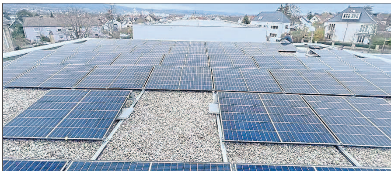
Die PV-Anlage auf dem Dach der TGM Budenheim.
