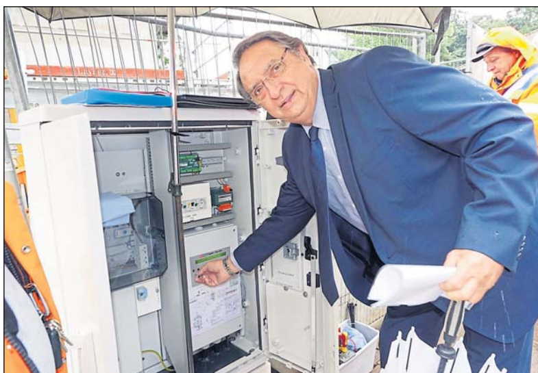
Bürgermeister Rainer Becker nimmt die neue Ampelanlage in Betrieb.
